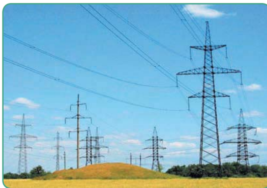
Рис. 71. Высоковольтная линия электропередачи
